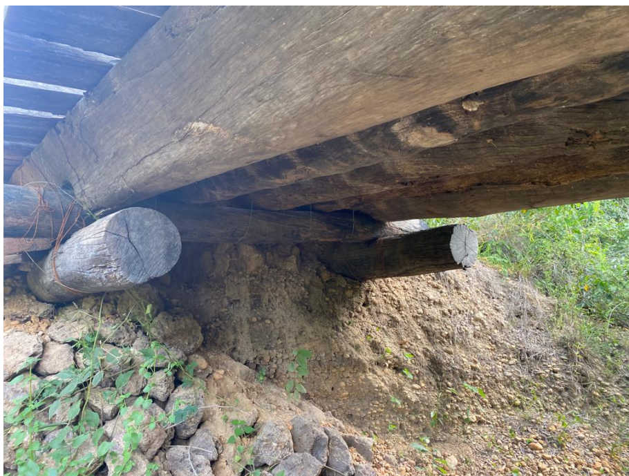
Foto 04: Necessita de cortina de proteção e melhoramento das Alas.
