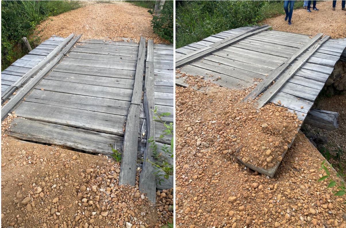
Foto 05 e Foto 06: Necessita de manutenção preventiva.
