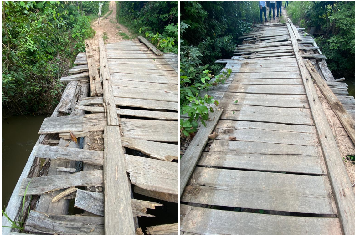
Foto 11 e Foto 12: Madeiramento danificado.
