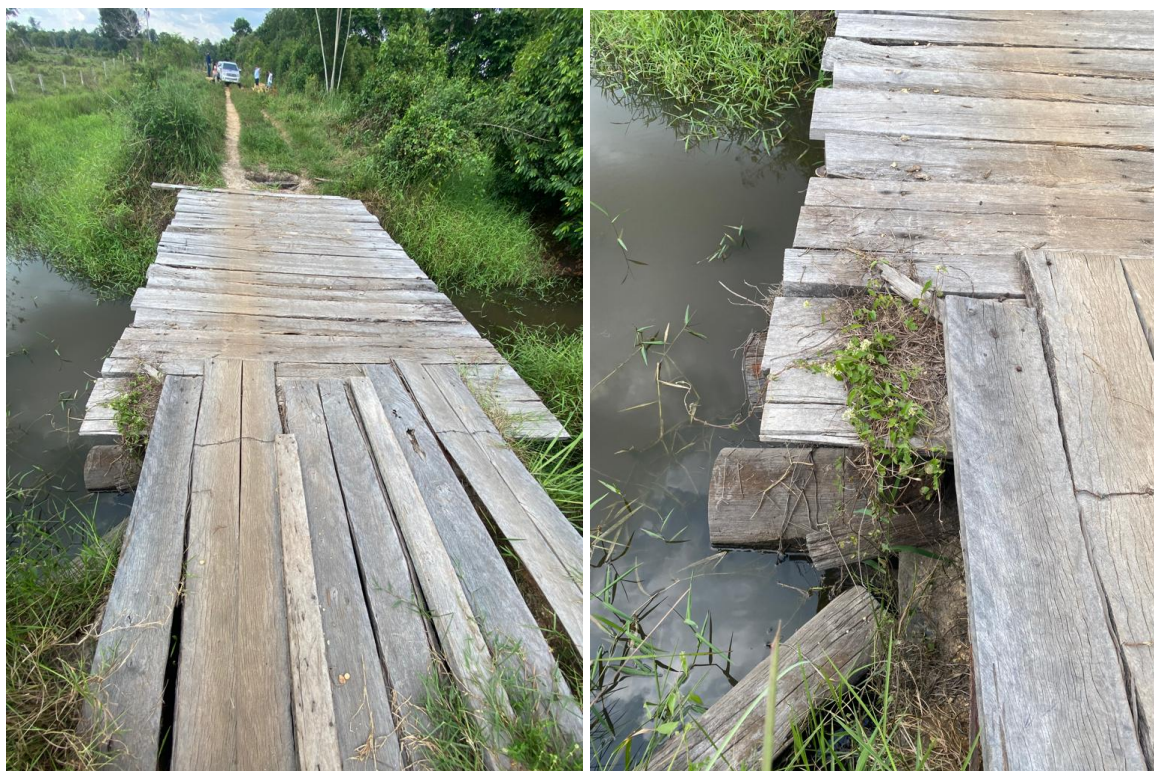
Foto 01 e Foto 02: Tablado irregular, com frestas e partes quebradas.
